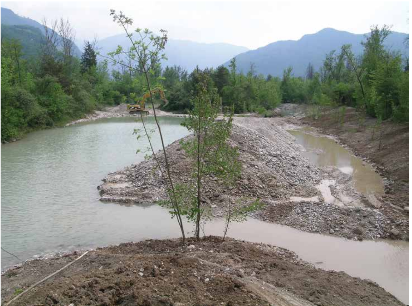
Fig. 19. Panoramica della parte centrale del Lago Verde dell'Isola durante l'esecuzione dei lavori di ripristino; a destra dell'escavatore è visibile l'isola situata al centro del lago.
