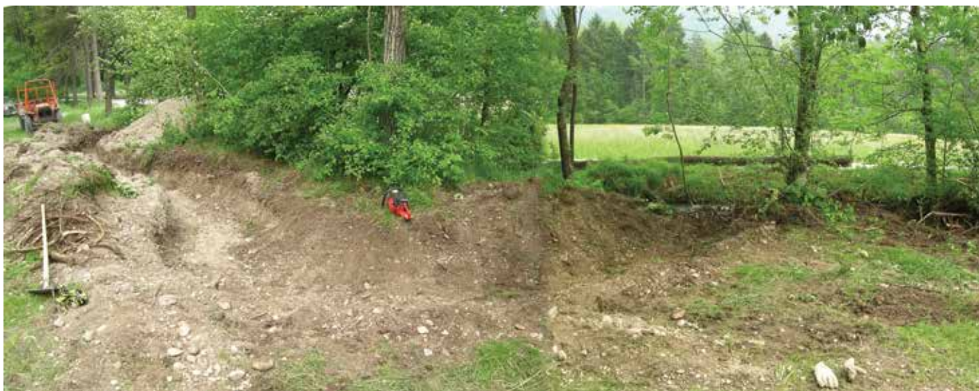
Fig. 2. Tratto di monte durante i lavori; a sinistra le radici della vegetazione asportate dalle ripe; oltre la vegetazione si intravede il corso del Rio Caoramello precedente all'intervento.
